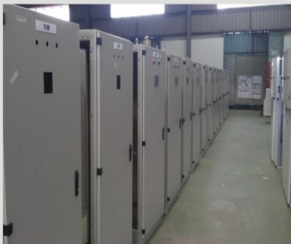
THIẾT KẾ CHIẾ TẠO, LẮP ĐẶT TỦ ĐIỆN ĐỘNG LỰC, ĐIỀU KHIỂN
