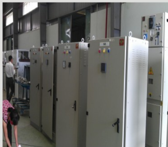
CẤP TỦ NGUỒN DỰ ÁN HANGAR 2 A76
