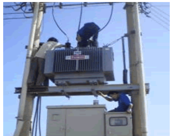
Trạm treo nhà máy bia sài gòn 1500kva/ Hanging Station brewery Saigon 1500KVA
