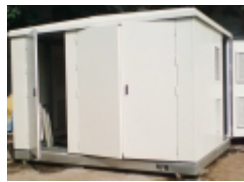
Trạm Kios 1/ Kios Station 1
