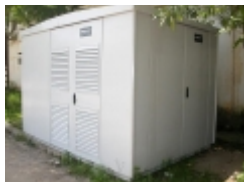
Trạm Kios 2/ Kios Station 2
