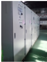
Tủ hạ thế/ Voltage cabinets
