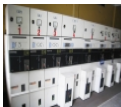
Tủ trung thế Schneider/ Medium voltage cabinets Schneider
