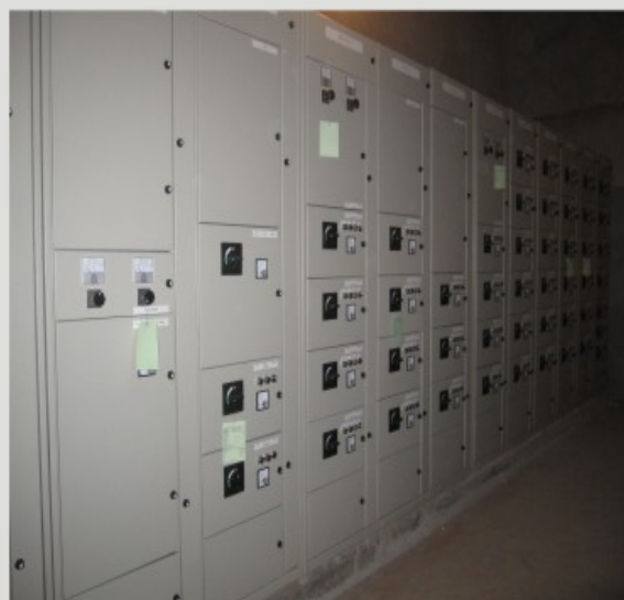
HỆ THỐNG TỦ CẤP NGUỒN HẠ THỂ
